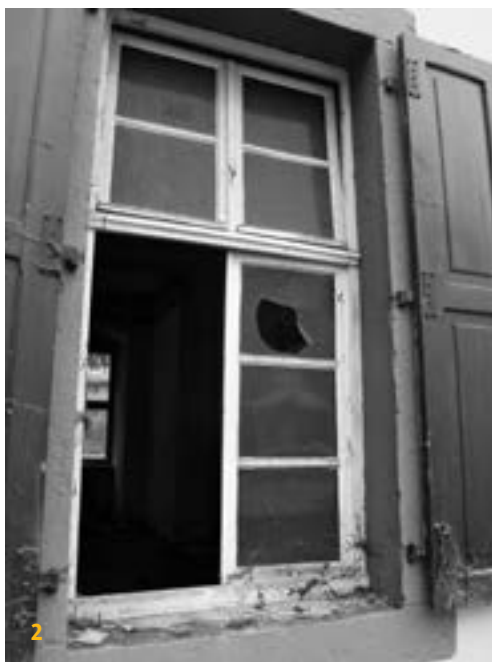
2 Denkmalrechtlich geschützte Fenster mit Resten der traditionellen Leinölkonservierung. Die Aufnahme entstand am Tag des Ausbaus und der Entsorgung aller historischen Fenster dieses städtischen Gebäudes.
