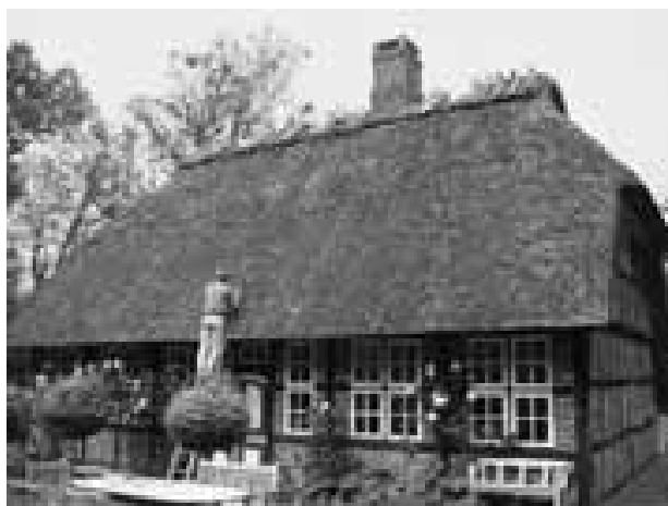
Schadhaftes Dach mit Rotteschicht, ca. 14 Jahre alt (Foto: K.-U. Schwarz)
