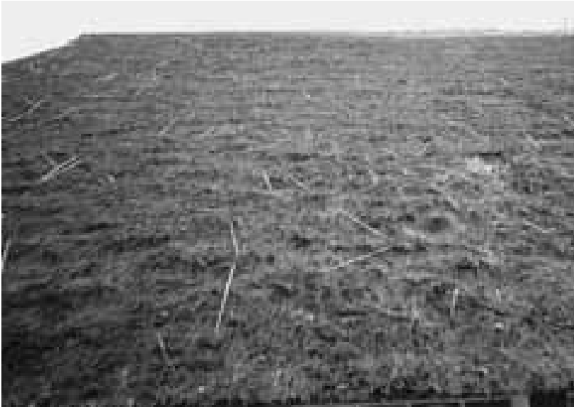
Stark befallenes Dach aus der 3. Gruppe des Stader „Reetkatasters“ (Foto: K. Püttmann)
