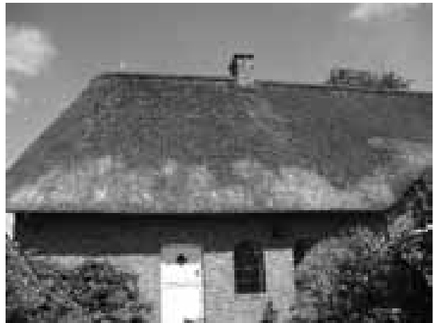
Großflächiger Pilzbefall auf einem Dach ca. 8 oder 9 Jahre alten Dach. Weißes Pilz-Myzel ist deutlich zu erkennen (Foto: K.-U. Schwarz)
