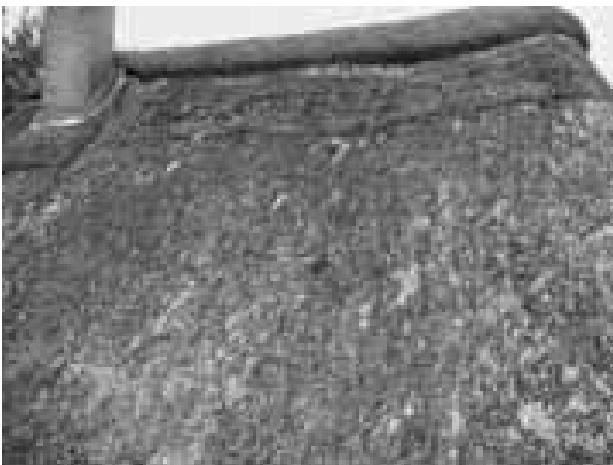
Ca. 50 Jahre altes Dach mit Moosbewuchs auf der Hauptdachfläche, aber ohne weitere Schäden (Foto: K.-U. Schwarz)
