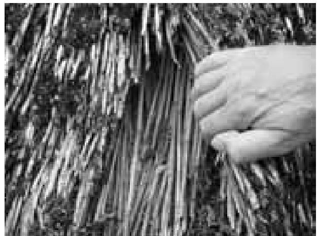
Ca. 50 Jahre altes Dach. Zieht man die Dachoberfläche leicht auseinander, ist nach wie vor die gut erhaltene Halmstruktur zu sehen (Foto: K.-U. Schwarz)
