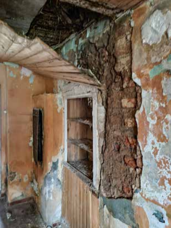
3, 4 Eindringendes Wasser hatte zu massiven Schäden im Inneren geführt
