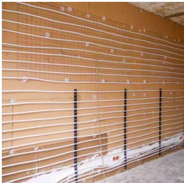
2 Heizrohr (oben auf Estrichgitter, unten auf Klicksystem)
