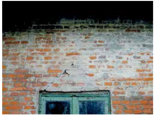
2 Abriss eines Fenstersturzes / Rissbildung
