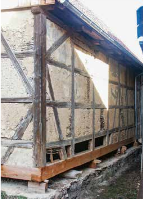
2 Die neue Schwelle wurde bei der ersten Sanierungsphase 2008 nicht untermauert (Foto: Stefan Haar)
