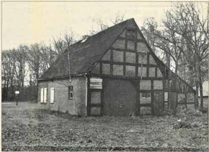
Nicht gerade eine Schönheit, baufälliger aber ein Schmuckstück: Das Häuslingshaus auf dem Dorfplatz in Otersen. Eigentlich war der Abriss schon beschlossene Sache, nun soll es doch erhalten und saniert werden. Der TSV Grün-Weiß will es pachten und nutzen. Foto: Beese
