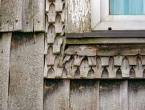
13 Klein- und Langschindeln kombiniert, an einem Wohnhaus in Radmühl (Foto: J. Michael Ruhl)
