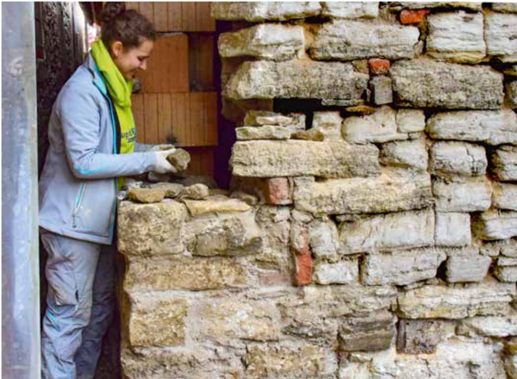
10 Die fehlende Mauerecke wird mit Bruchsteinen aus einem anderen Hausabbruch aufgemauert. (Foto: Jugendbauhütte Regensburg)
