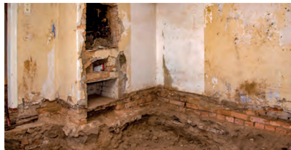
5 Der Boden unter der Altenteilerstube ist ausgehoben und wird durch Schaumglasschotter ersetzt.
