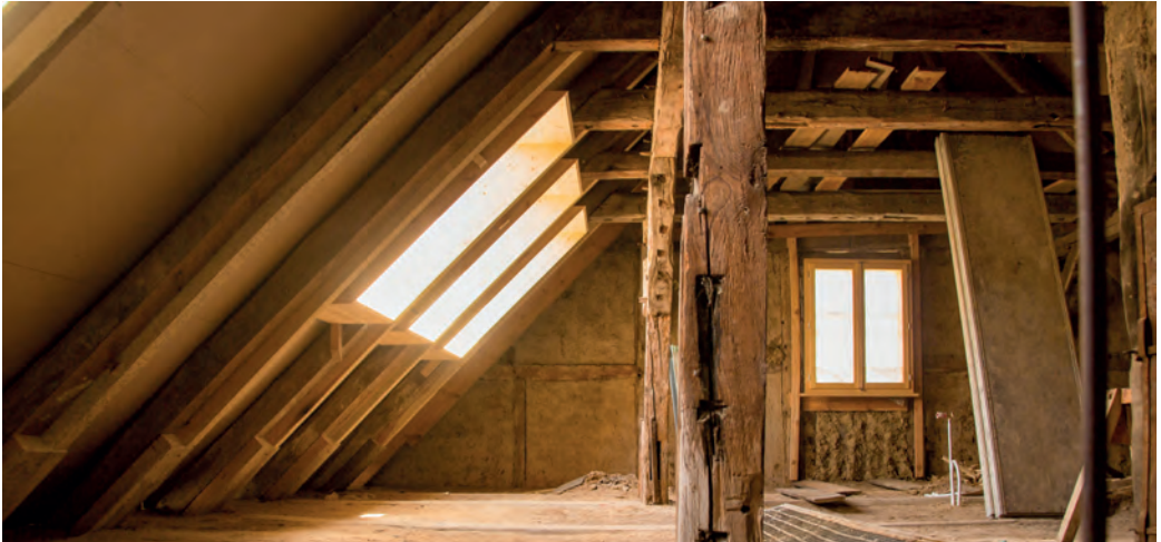
4 Neben die alten Dachsparren wurde neue Sparren gestellt, die nun die Last des Daches tragen. Zugleich bietet ihre Dimensionierung den nötigen Raum für die Einblasdämmung.
