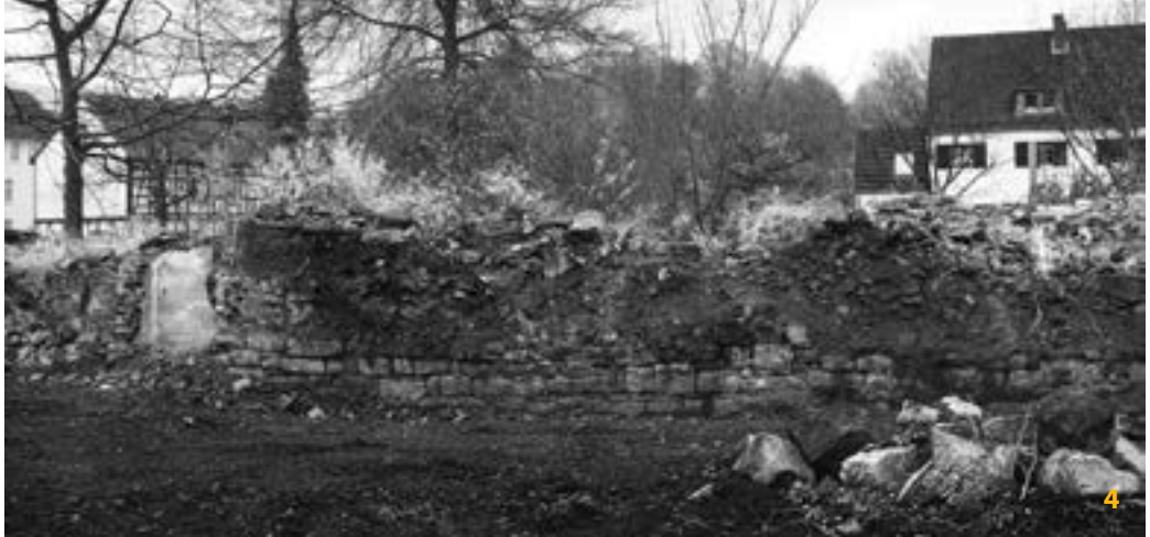
4 Seitenansicht des Mauerabschnitts nach starker Beschädigung und Abtrag
