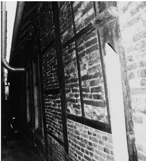
Abb. 6: Schüttdorf, Bürgerhaus Singel ...: Großformatiges Zargenfenster der Bauzeit (um 1600), das ungewöhnlicherweise komplett mit feststehenden Bleiverglasungen versehen war.
